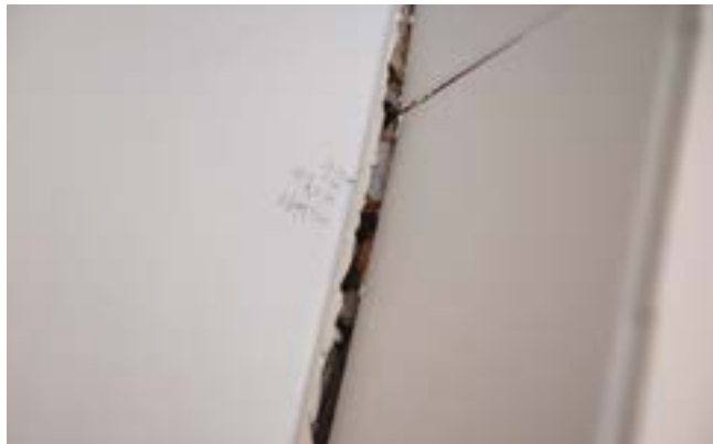
...jusqu'à ce que les sols et les murs se fissurent.
