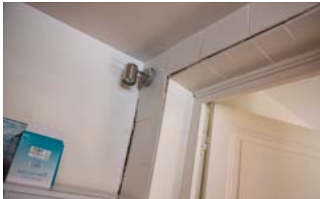
...ont causé de fortes contraintes sur le bâti et les fondations
