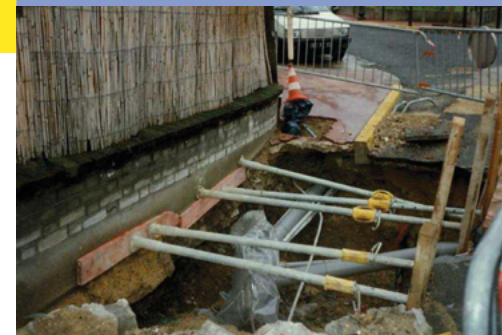
Effondrement avenue de Bellevue 1995 - Bagnolet (93) | Crédit : IGC
