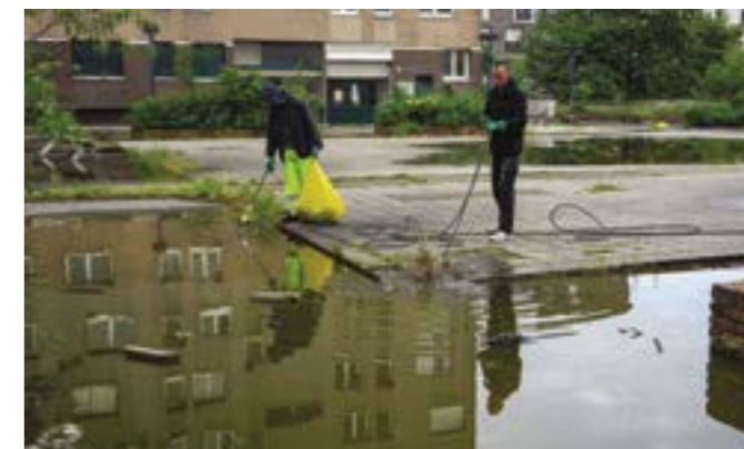
La dalle Maurice-Thorez connaît actuellement d'importants problèmes de stagnation et d'infiltration d'eau.
